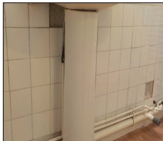
Colle amiantée sous faïence
