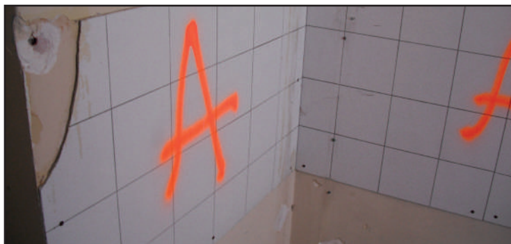
Repérage de colle amiantée sous faïence
